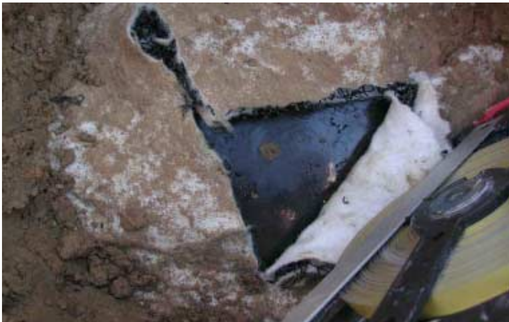
Abbildung 5: Leckage im Testfeld Altdeponie
