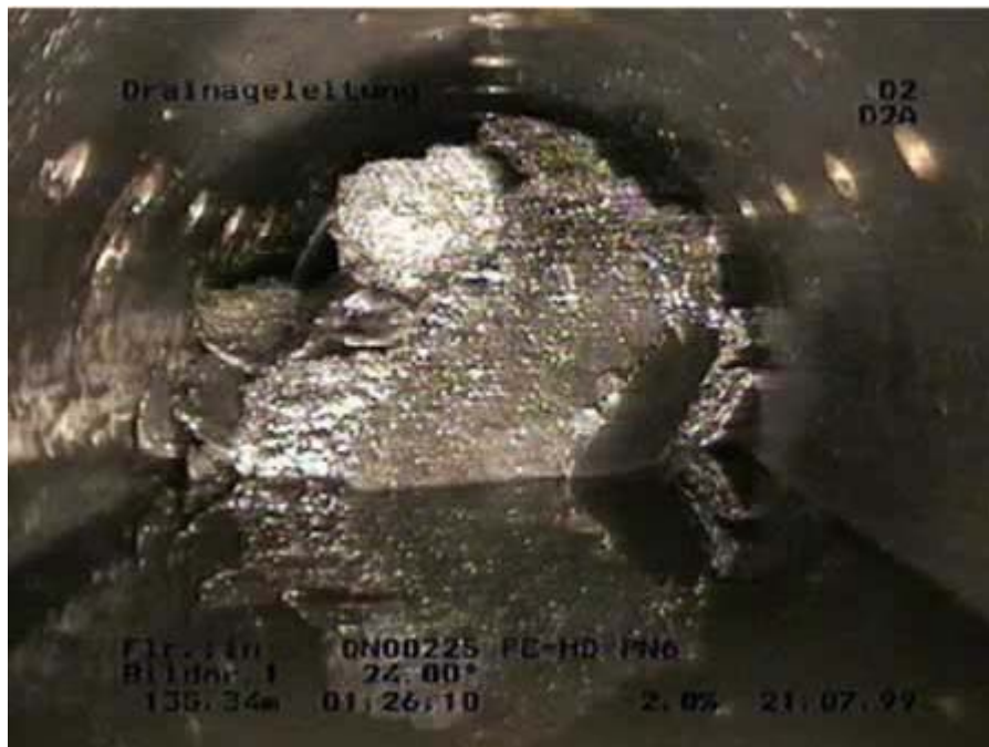
Abb. 9: Versperrung des Rohrquerschnittes durch massive Ablagerungen
