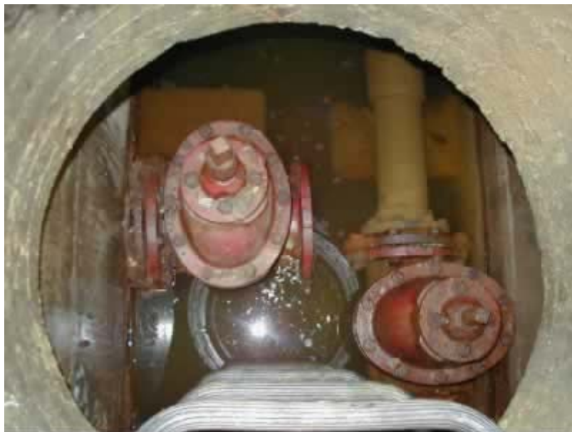
Abb. 11: Versperrter Zugang zu Leitungen durch defekte Schieber
