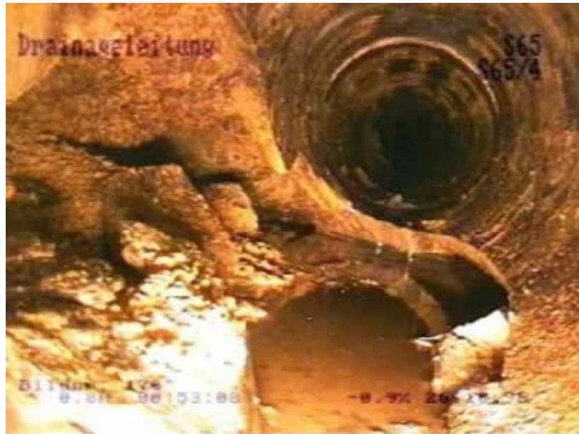
Abb. 10: Fehlendes Stück in der Rohrsohle einer Hauptdrainageleitung
