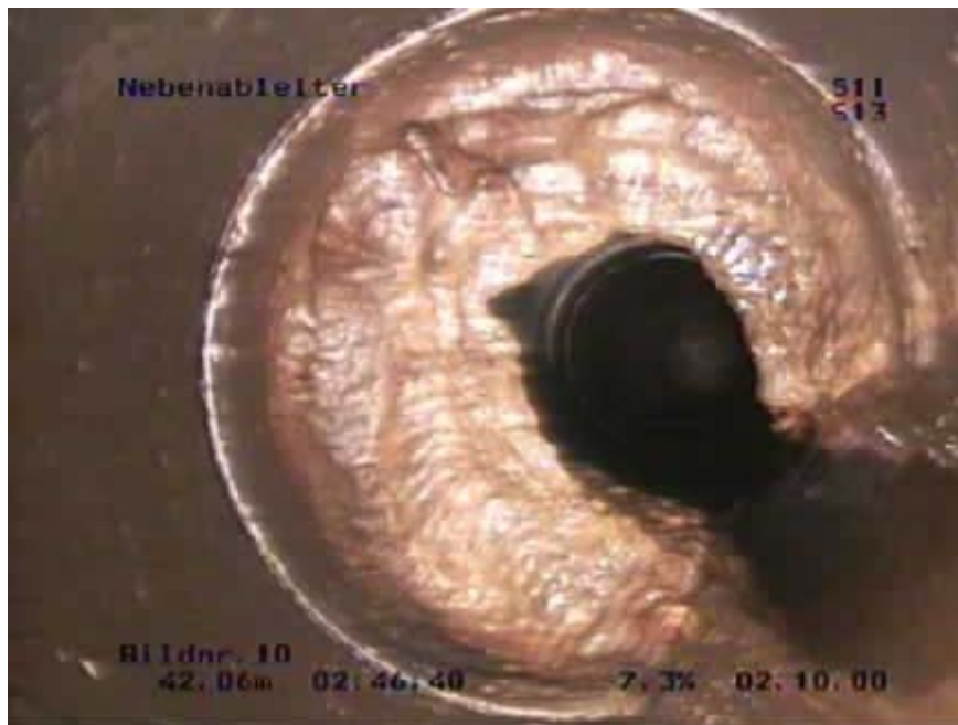
Abb. 12: Sich langsam schließende, ringförmige Ablagerung in einem Nebenableiter
