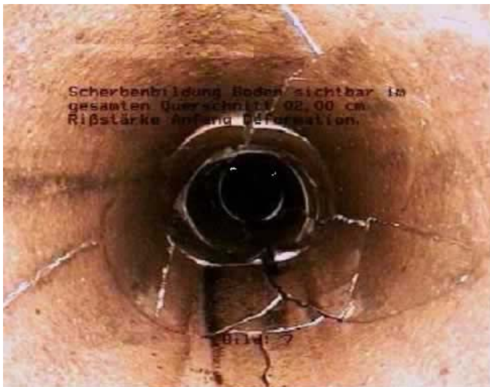
Abb. 8: Scherbenbildung in einer Transportleitung außerhalb der Basisabdichtung
