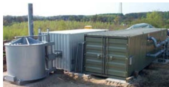
Gasverdichterstation und Abluftreinigung
