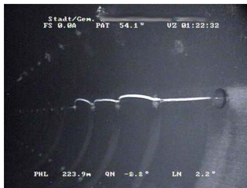
Bild 6: Sich fortsetzender Riss von Loch zu Loch
