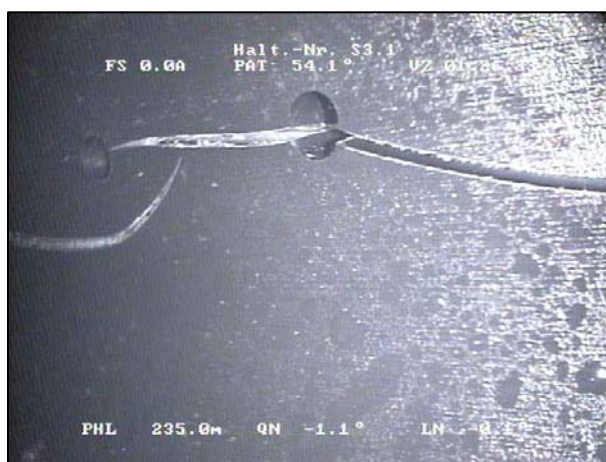
Bild 5: Typischer Längsriss beginnend an einem Drainageloch
