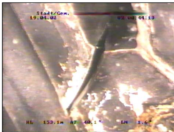
Bild 4: Risse, ausgehend von einem Schlitz
